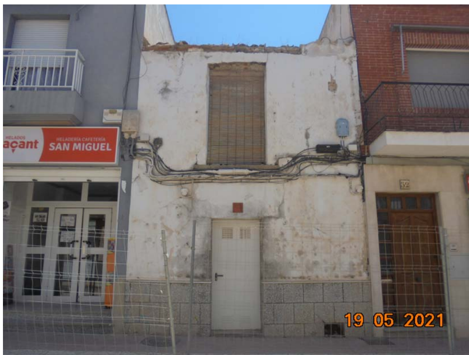
FOTOGRAFÍA DE LA FACHADA A LA AVENIDA DE ANDALUCÍA DE LA FINCA REGISTRAL 1724
